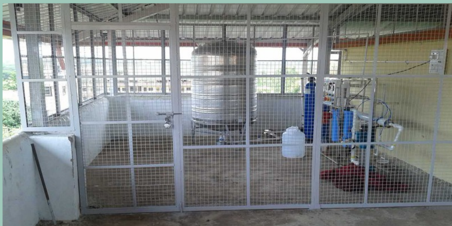
de waterzuiveringsinstallatie van 2017 - nu is een nog een veel grotere nodig
